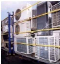
回収し、保管されたエアコン
