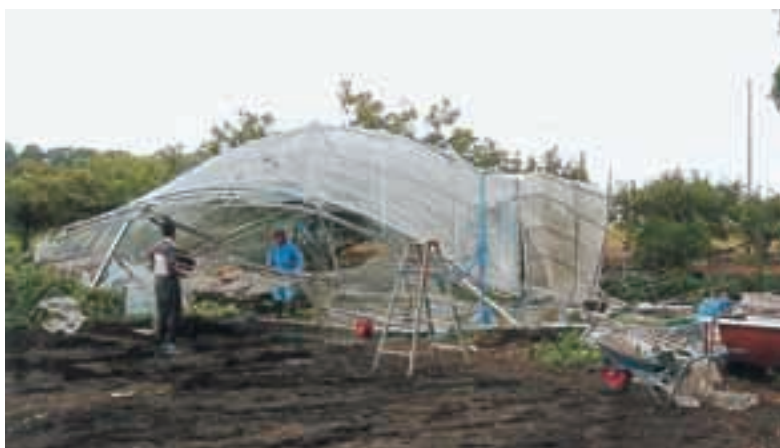
▲台風16号の暴風で倒壊したビニールハウス
